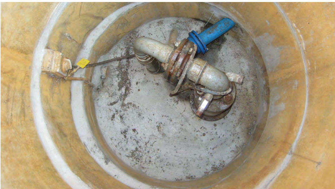
Tørbrønd med støbt bund og tætning mellem brøndringe. Foto: Kolding Kommune.
