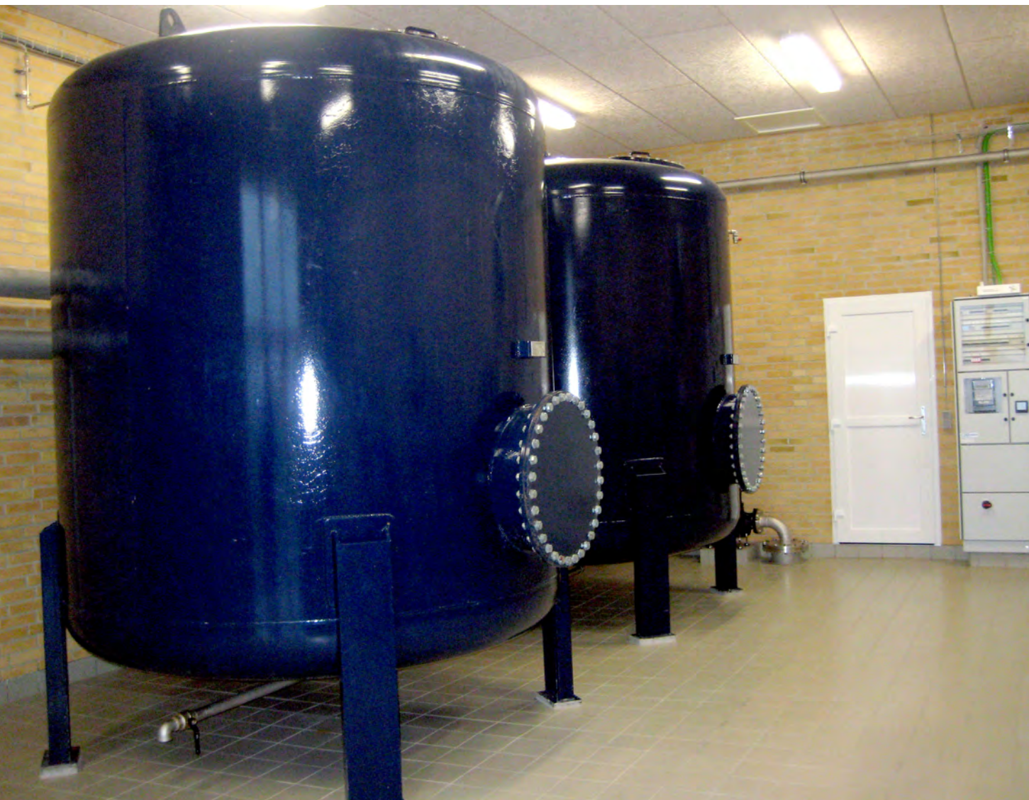
Lukket filteranlæg på Forbundsvandværket. Foto: Kolding Kommune.
