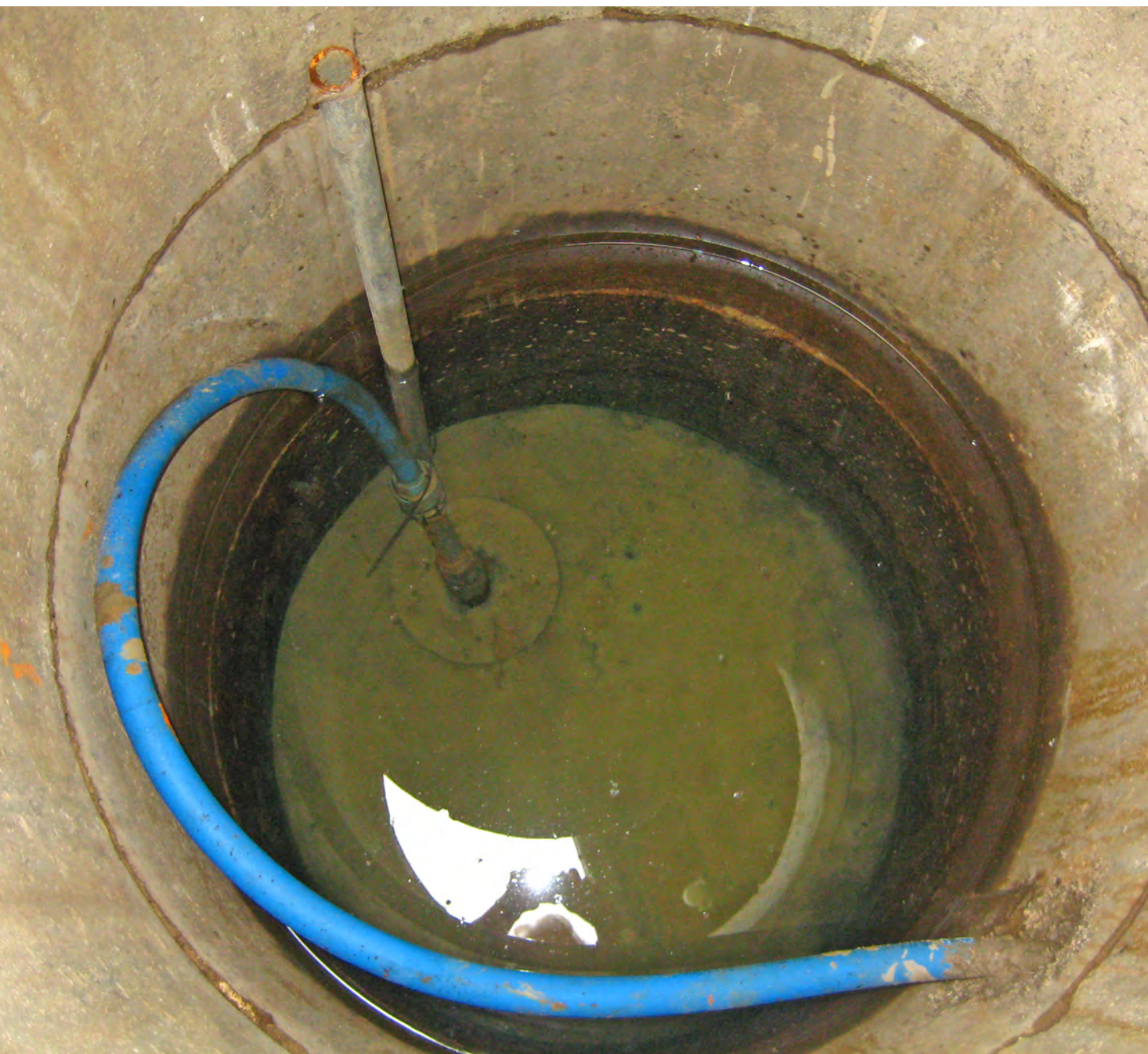
Oversvømmet boring. Foto: Kolding Kommune.
