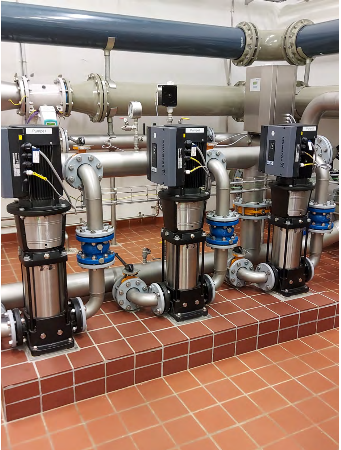
Rentvandspumper på Østre Vandværk, TREFOR Vand. Foto: Kolding Kommune.
