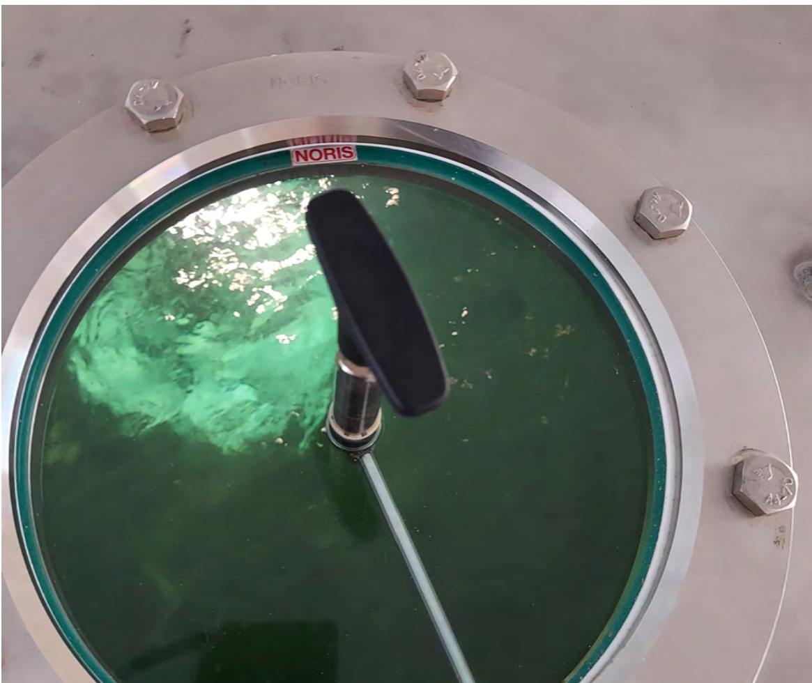
Renvandstank - Bøgebjerg Vandværk. Foto: Kolding Kommune.
