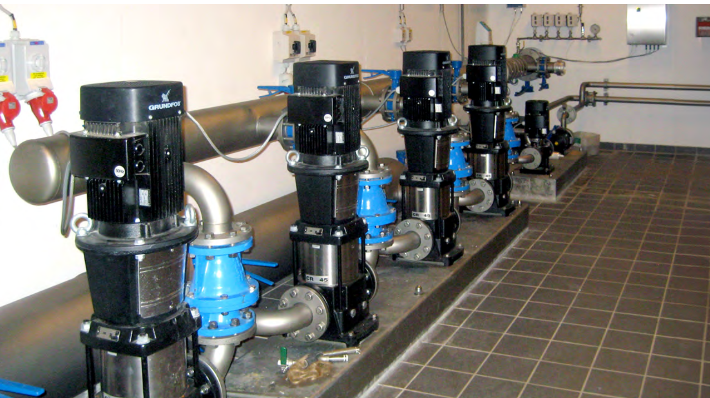
Rentvandspumper på Vamdrup Vandværk. Foto: Kolding Kommune.
