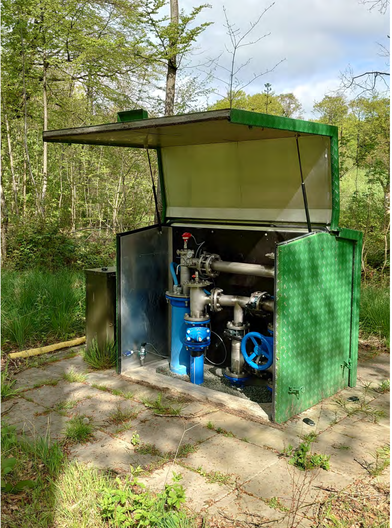
Råvandsstation ved Forbundsvandværket. Foto: Kolding Kommune.
