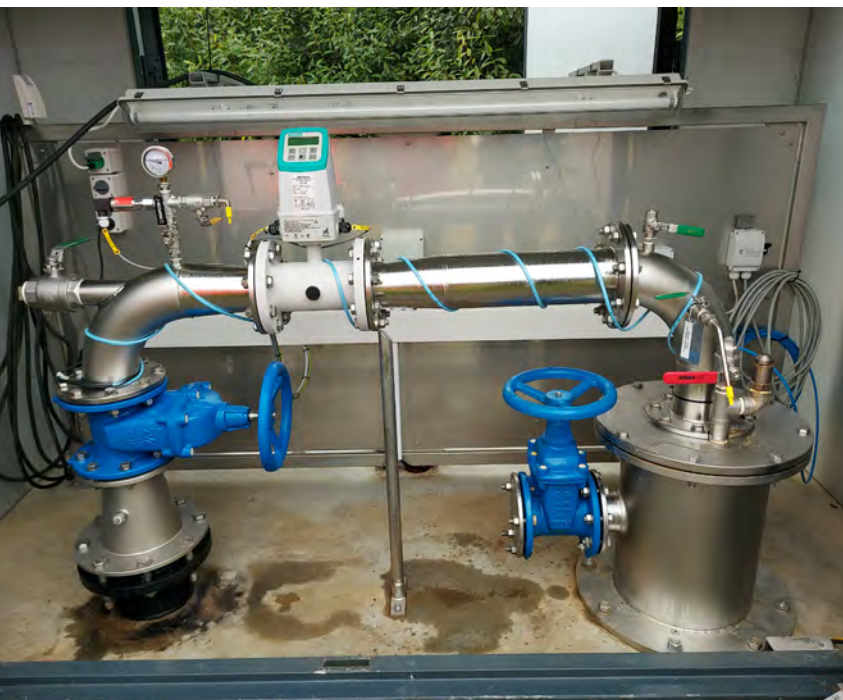
Råvandsstation. Foto: Kolding Kommune.
