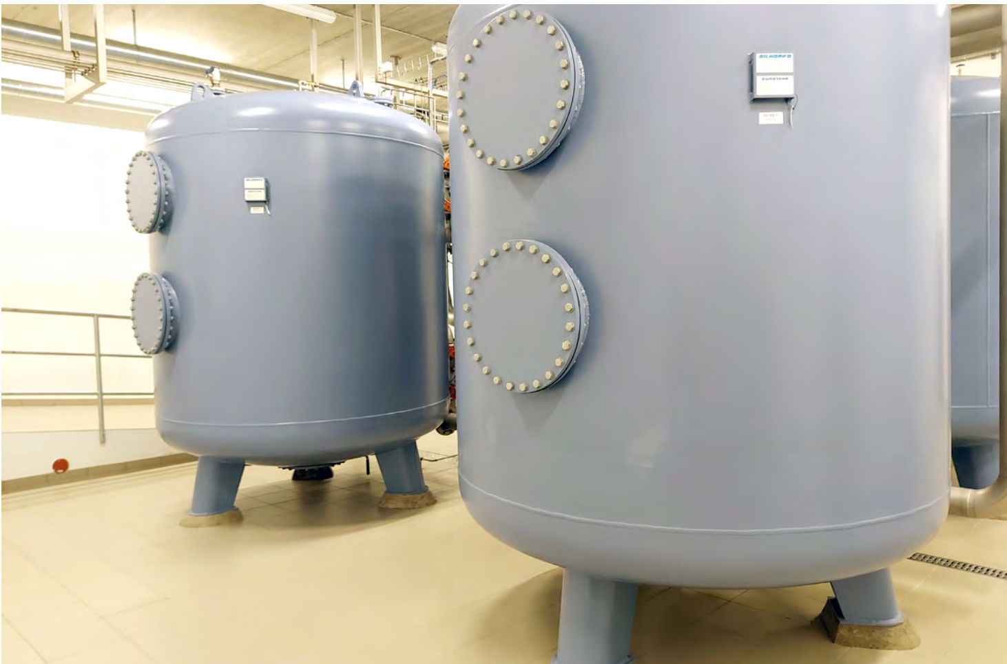
Lukkede filtre på Vonsild Vandværk. Foto: Kolding Kommune.
