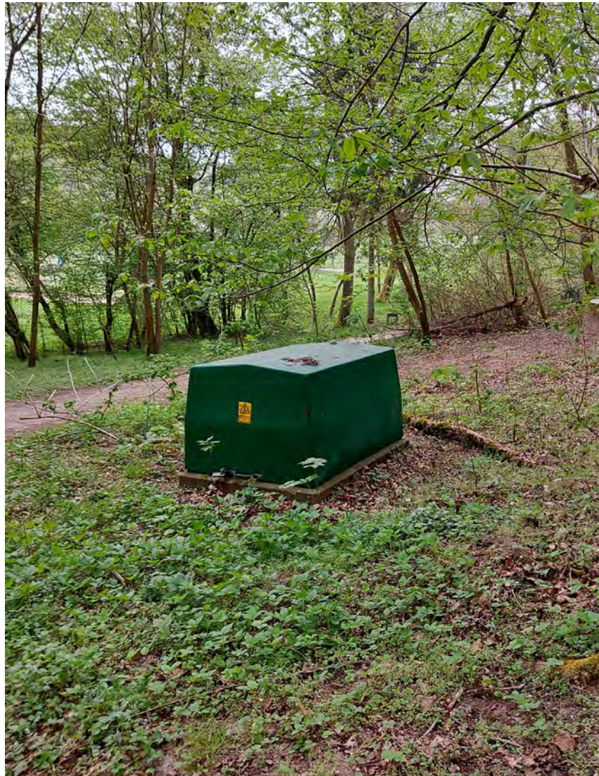
Råvandsstation på kildepladsen til Bramdrupdam Vandværk - Sønderholm. Foto: Kolding Kommune.
