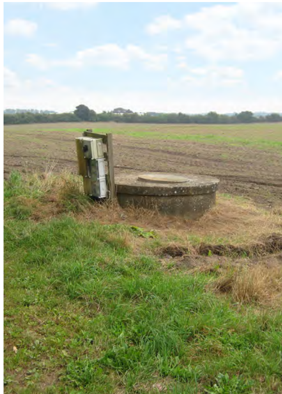
Beskyttelseszone ikke overholdt. Foto: Kolding Kommune.
