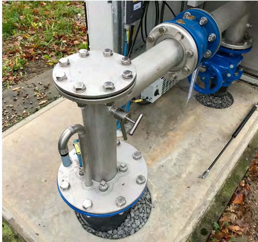
Råvandsstation – Christiansfeld Vandværk. Foto: Kolding Kommune.
