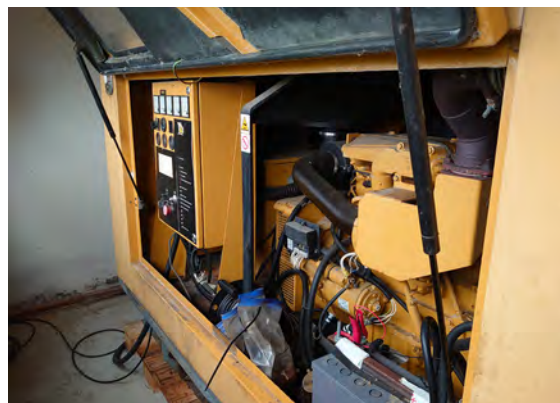
Nødstrømsanlæg på Forbundsvandværket. Foto: Kolding Kommune.
