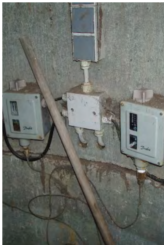
Timetæller i tørbrønd til markvandingsboring. Foto: Kolding Kommune.
